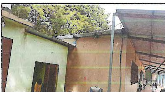
Foto 10: techo incompleto de corredor
